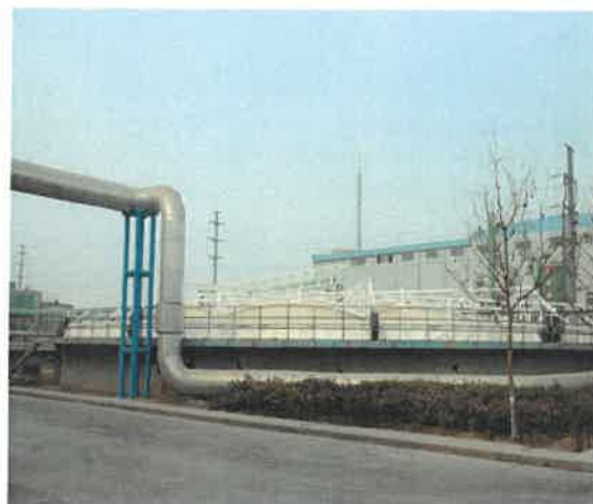
一沉池异味处理设施
