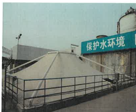
1#集水池异味处理设施
