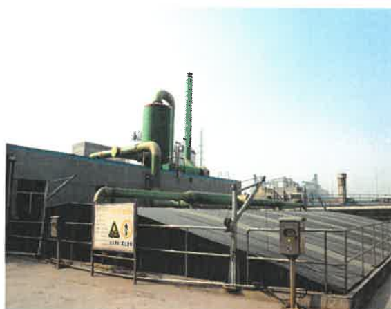
2#集水池异味处理设施
