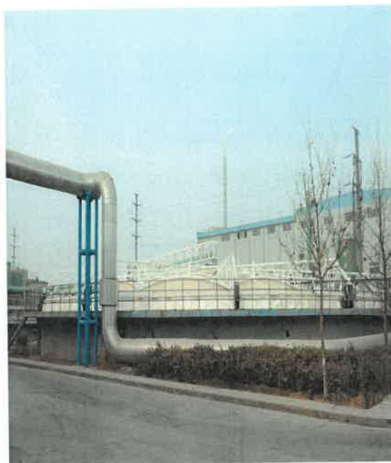
一沉池异味处理设施
