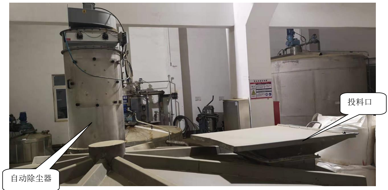
料仓投料口及除尘照片
