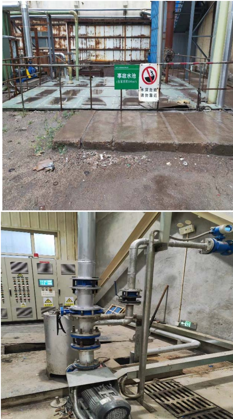
图 4-5 应急事故水池及切换装置
