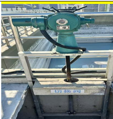
应急事故水池及切换阀
