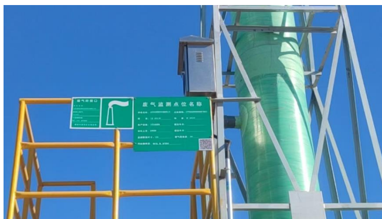
污水处理站及废气处理设施、排气筒 P2 采样平台
